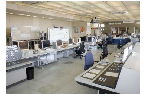
総合管理所の操作・監視室
