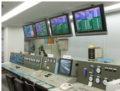
下淵頭首工の操作・監視室
