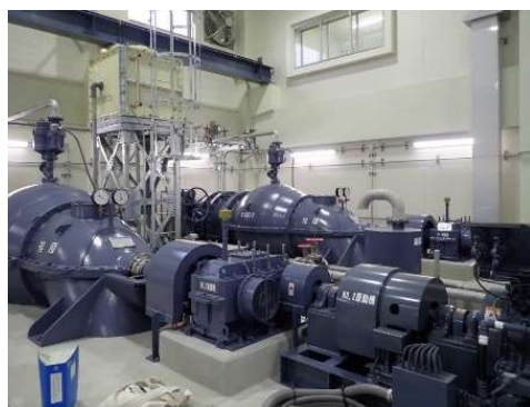
米田排水機場内のポンプ (改修前：3.7m 3 /s→改修後：4.5m 3 /s)
