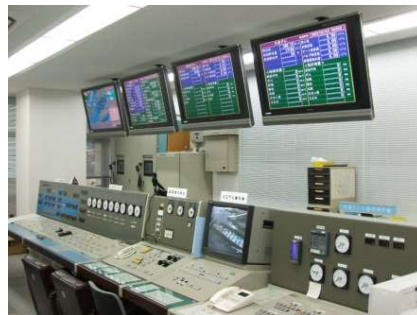
下淵頭首工の操作・監視室
