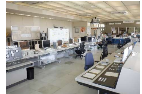
総合管理所の操作・監視室
