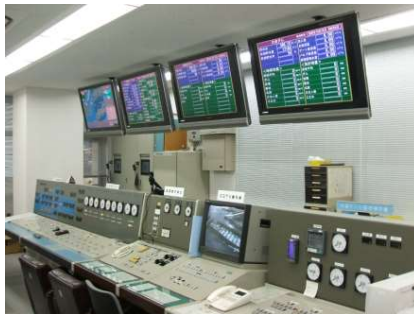
下淵頭首工の操作・監視室
