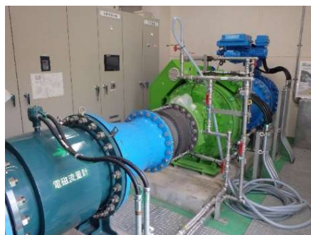
呑吐ダム小水力発電施設 (プロペラ水車、最大発電量275KW)
