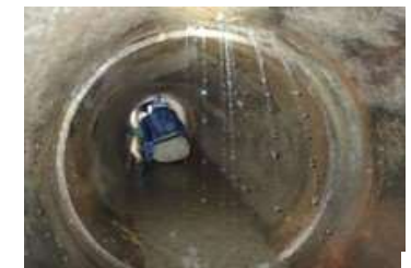
管水路の漏水状況
