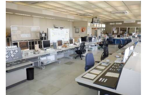
総合管理所の操作・監視室
