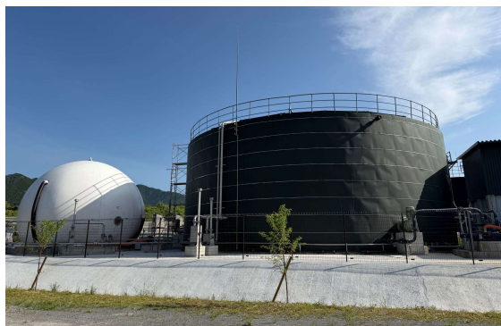
【箸荷バイオガス発電所施設】
