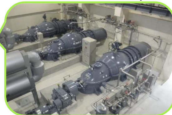
新しい排水ポンプ
