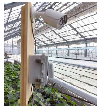
遠隔監視装置
