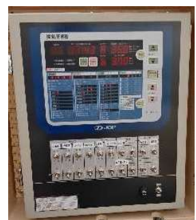
自動換気装置
