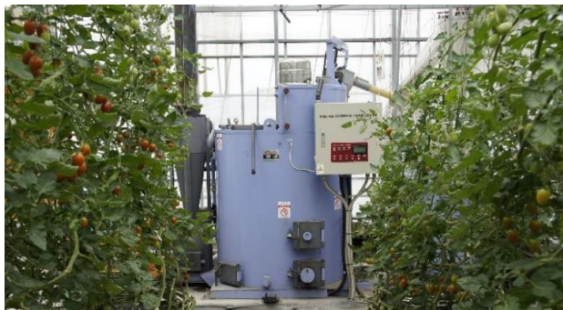
木質バイオマス加温機の導入
