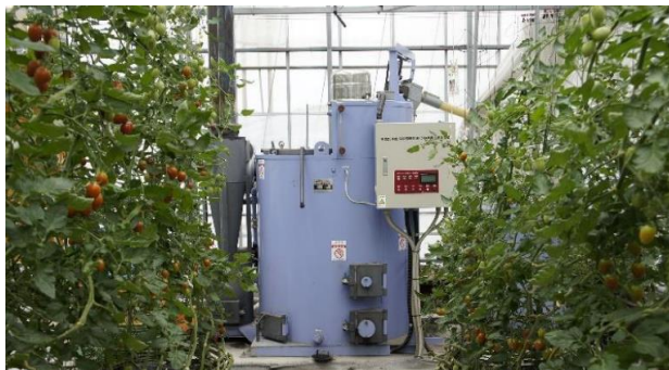
木質バイオマス加温機の導入
