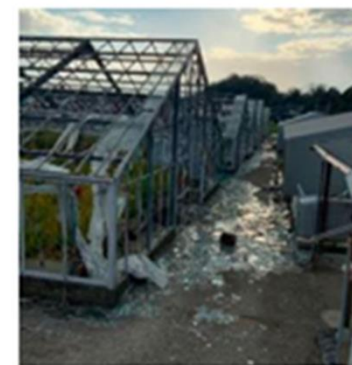
台風で被災したガラスハウス (2019年房総半島)
