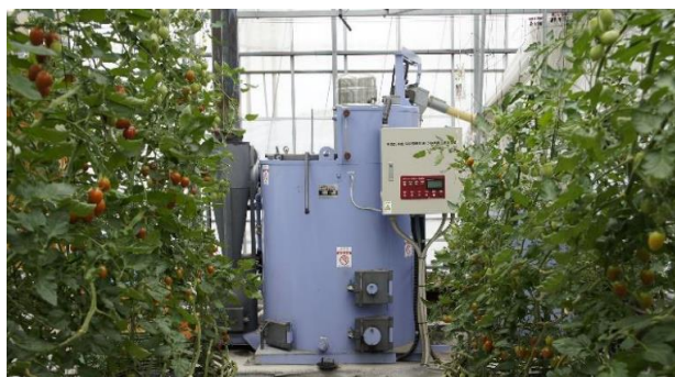
木質バイオマス加温機の導入
