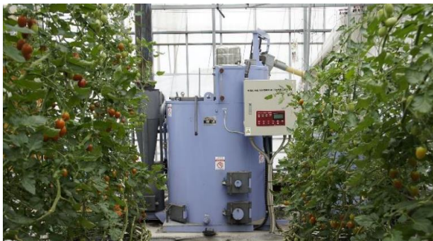
木質バイオマス加温機の導入
