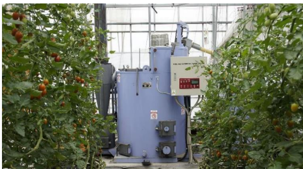
木質バイオマス加温機の導入
