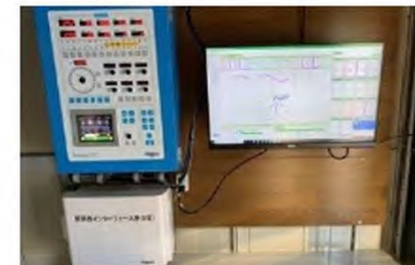
施設園芸:統合環境制御装置
