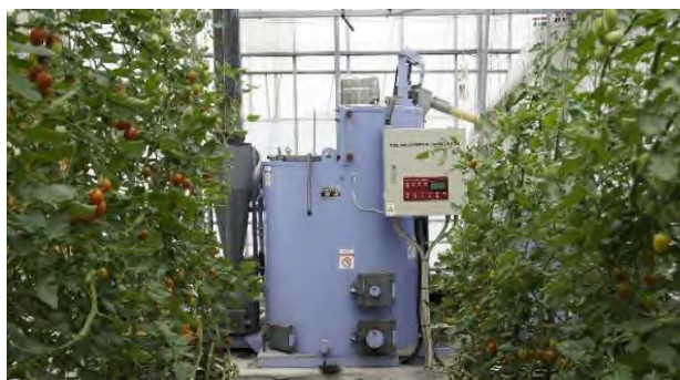
木質バイオマス加温機の導入
