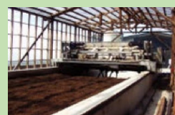
良質な堆肥を供給する 堆肥化処理施設
