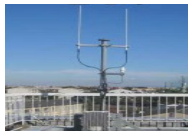
通信施設の整備
