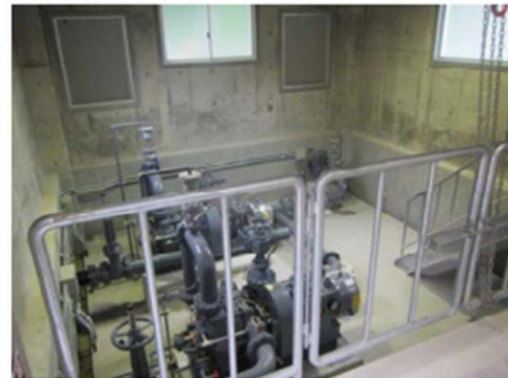
写真 5-6-4 大峯揚水機場(室内)
