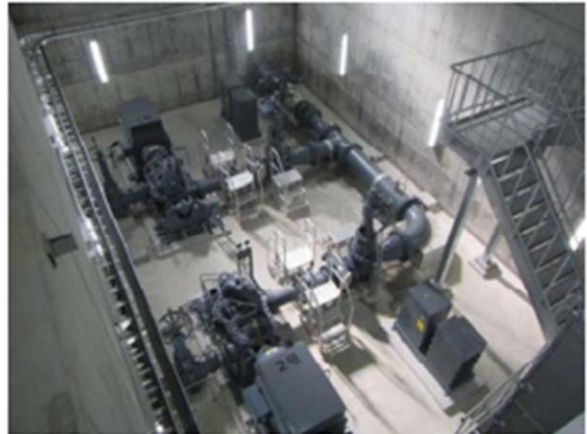
写真 5-6-2 金丸揚水機場(室内)
