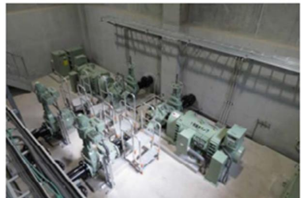
写真 5-6-6 高之峯揚水機場(室内)
