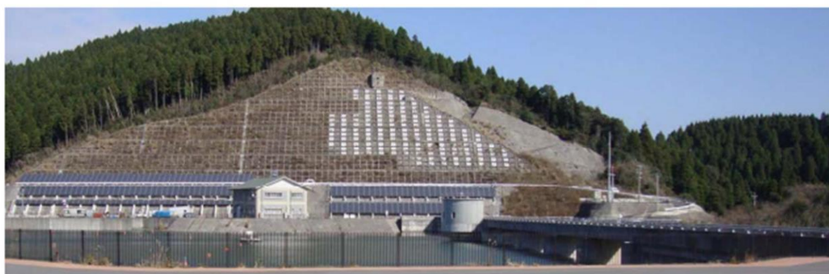
写真 5-9-2 太陽光パネル
