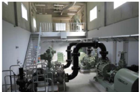
写真 5-6-8 外園揚水機場(室内)
