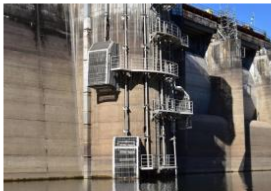
北山ダム取水ゲート
