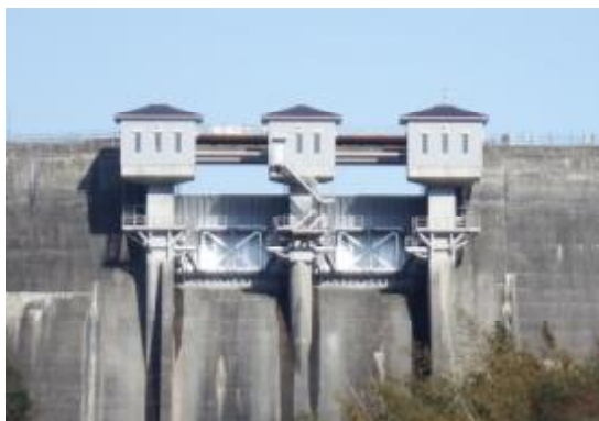
北山ダム洪水吐きゲート(下流側)
