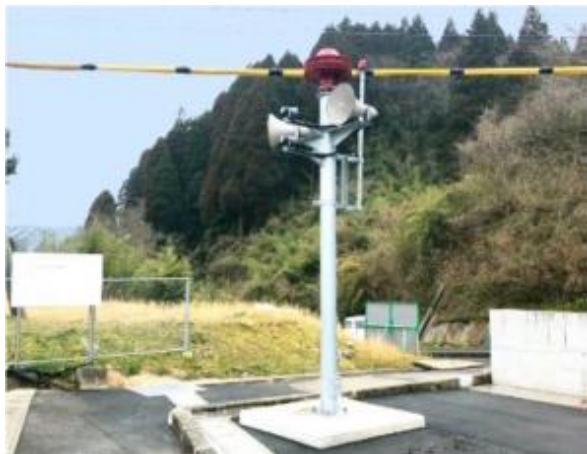
ダム放流警報設備
