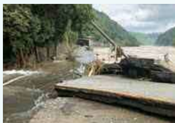
被災状況（国道の崩落）
