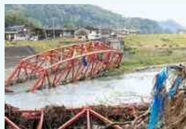
被災状況（落橋）
