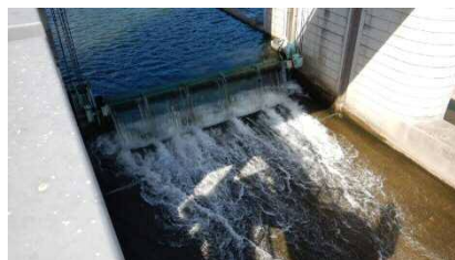
図3 川上頭首工_右岸ゲート
