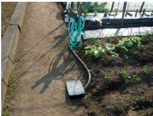
数区画毎に設置された散水栓
