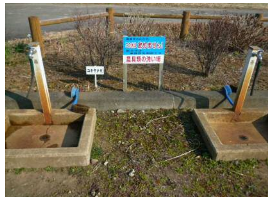
ため池の水を活用した農機具洗い場
