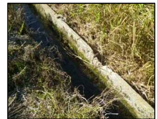
用水路の老朽化
