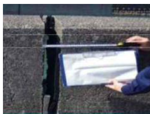
堤防の老朽化
