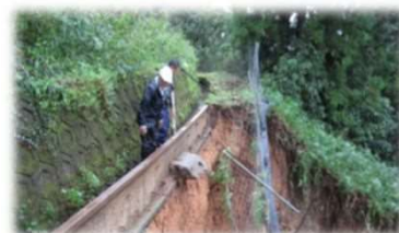
農業用水路の被害 (宮崎県高千穂町)
