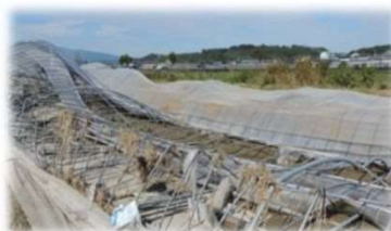
農業用ハウスの倒壊 (宮崎県新富町)
