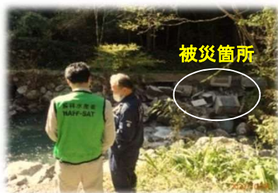
技術系職員による農業用水路の被害状況調査
