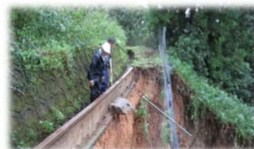
農業用水路の被害 (宮崎県高千穂町)
