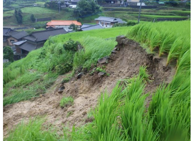
令和3(2021)年8月の豪雨で崩壊した棚田の石垣 写真提供：波佐見町
