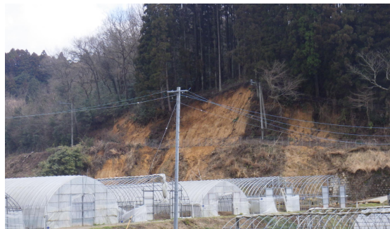
大雨で崩れた法面
