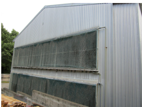
鶏舎に設置された野生動物侵入防止のための防鳥ネット
