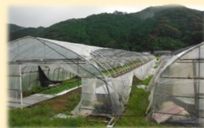
農業用ハウスのビニールの損壊 (大分県佐伯市)
