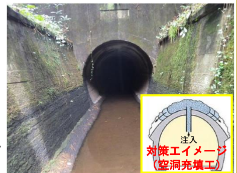
明渠及び坑口
