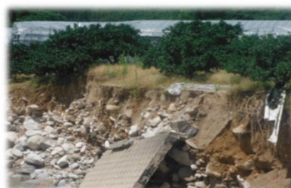
みかん園地の法面崩壊 (佐賀県唐津市)
