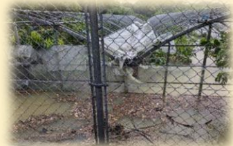
マンゴーハウスの冠水 (鹿児島県与論町)
