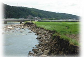
堤防崩落による法面と耕地の一部流失 (大分県国東市)
