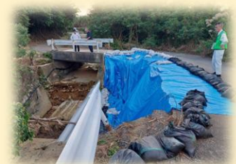
技術系職員による被災 状況調査
