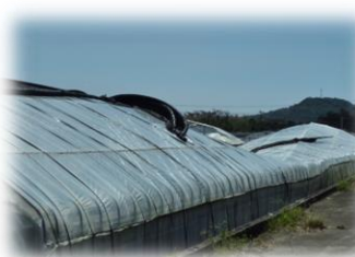
花きビニールハウスの損壊 (鹿児島県枕崎市)
