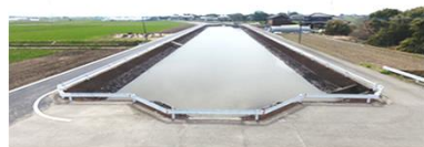
防災事業により、安定した水利用が可能となったクリーク (筑後川下流右岸地区(佐賀県))
