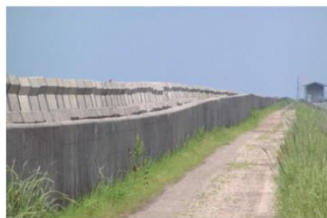
沈下が著しい堤防
