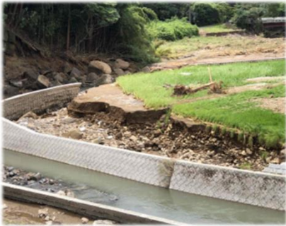
水田への土砂流入 (鹿児島県始良市)
