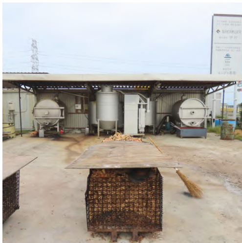
エッセンシャルオイルの 蒸留工場と炭化設備
