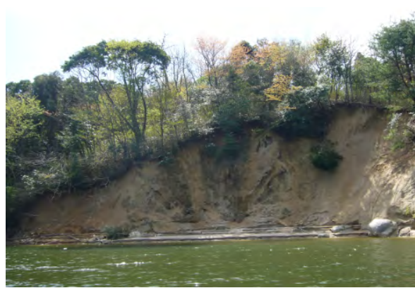
貯水池周辺法面の崩壊状況
