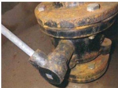
錆により作動不良の空気弁
