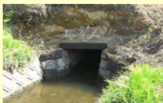
通潤用水（下井手13号水路上流坑口）
