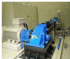
小水力発電施設（イメージ写真）
