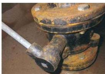
錆により作動不良の空気弁
