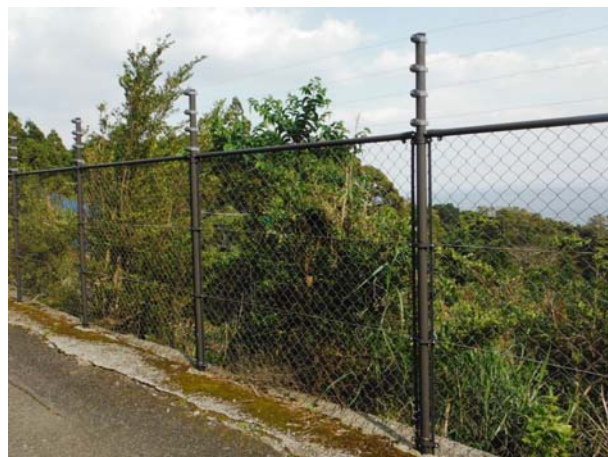
侵入防止柵（金網＋電気柵）
