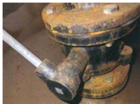
錆により作動不良の空気弁
