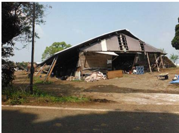
畜舎倒壊の被害
