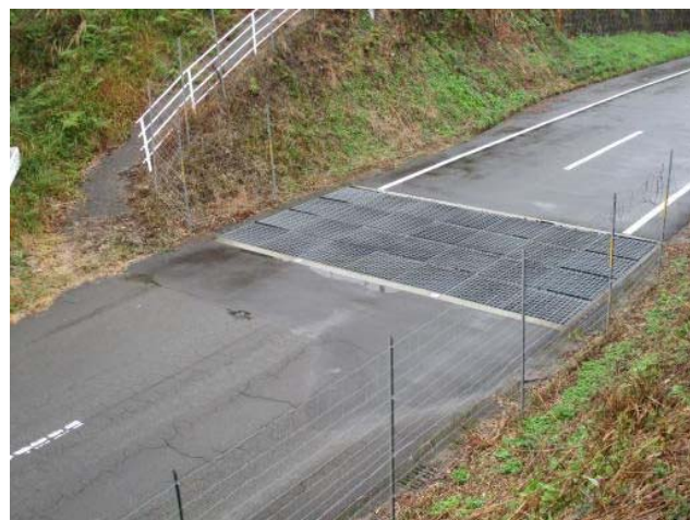
侵入防止柵（金網）とテキサスゲート※
