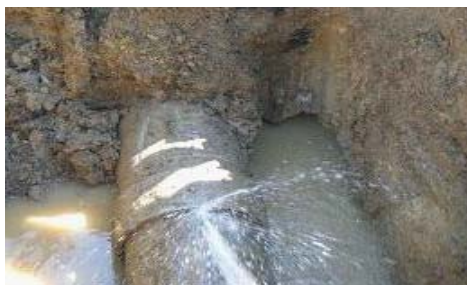
管水路の漏水
