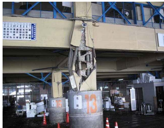
卸売市場施設の被害
