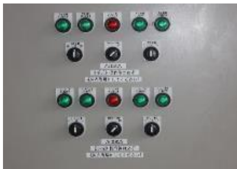
制御装置(一部)
