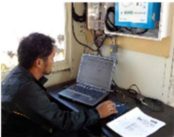
ハウス内の様々な データを確認
