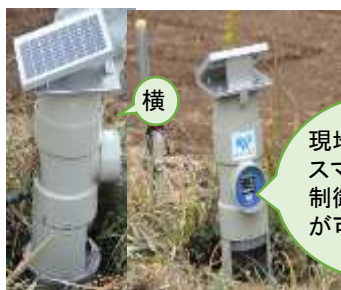
遠隔操作水管理システム(自動給水栓)
