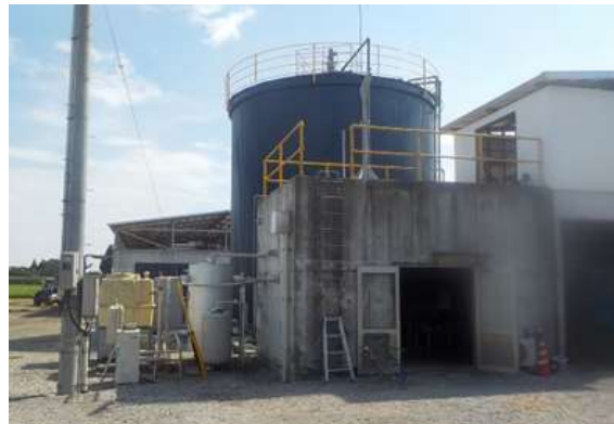
本部農場内に設置されたバイオガスプラント
