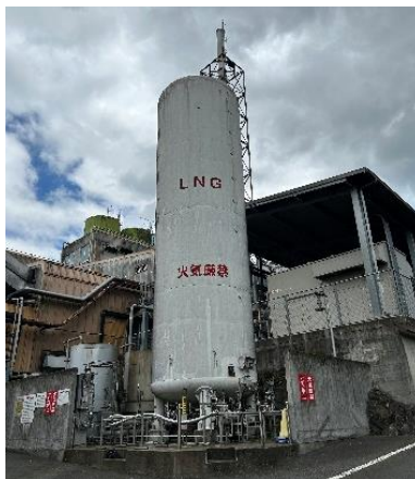
【液化天然ガス受入設備】
