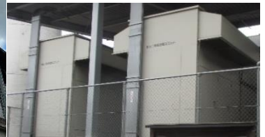
【コージェネレーションシステム】
