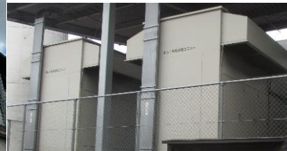
【コージェネレーションシステム】
