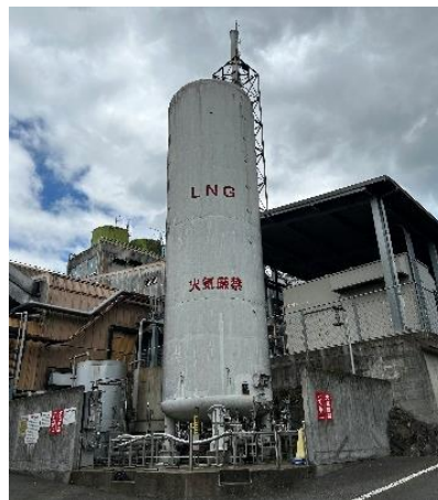
【液化天然ガス受入設備】
