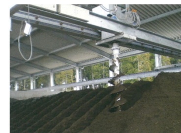
堆肥自動攪拌機 等
