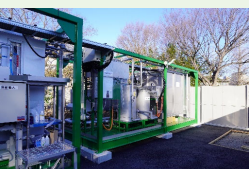
超小型 バイオガスプラント
