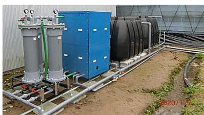
養液ろ過装置
