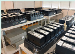
バッテリー保管・充電施設
